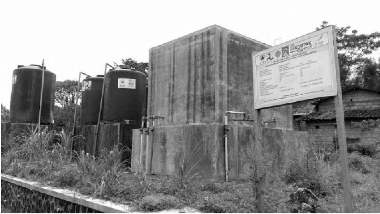
Gambar 8. Instalasi Air Bersih di Huntap Plosokerep.
