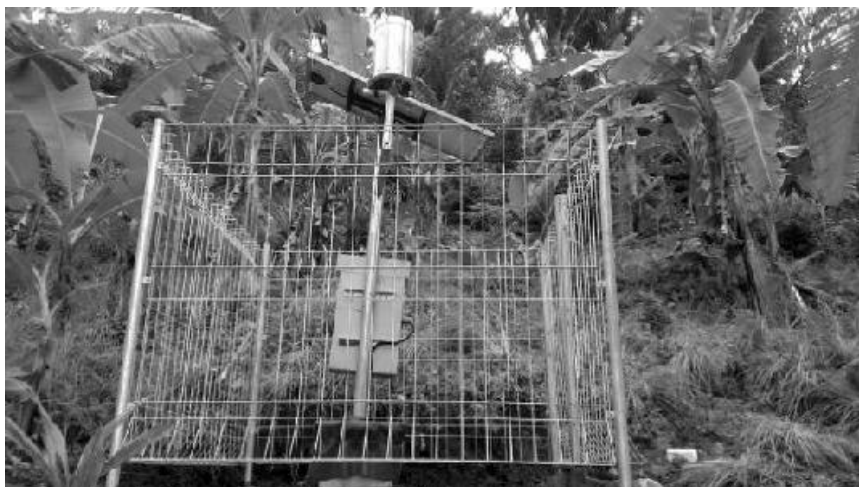
Gambar 6. Contoh Foto Stasiun Pemantauan Gerakan Tanah Terpasang. Box Merah di Bawah adalah Pelindung Ekstensometer. Box Besi Yang Terikat di Tiang Berisi Batere Beserta Regulator Solar Panel dan GPRS Data logger. Di Bagian Atas Tiang Ada Sensor Penakar Curah Hujan dan Solar Panel.
